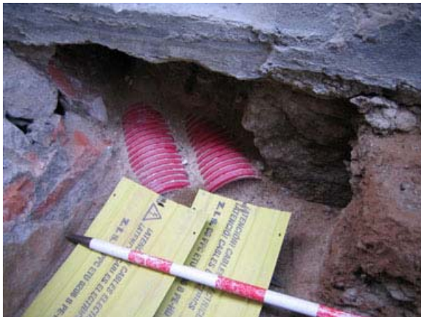
FOTO 3. Vista de la muralla romana on està atravesada pels serveis
